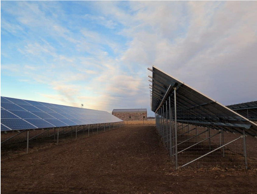
220 kW Solar Array
